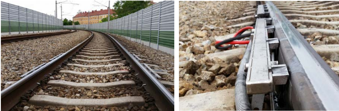
Abb. 5-35: Installierte Schmierleisten für die Schienenkopfkonditionierung während der Messkampagne 1, Kleinschwechat/S7
